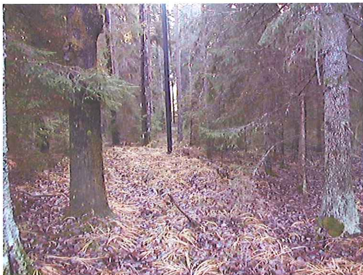
Figur 2. Befintlig luftledning för elmatning till Sjöhaget.
