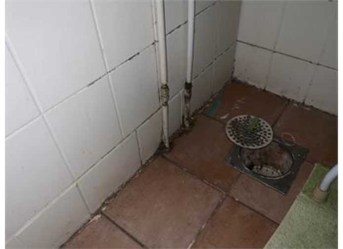
Golvbrunn och rörgenomföring i badrum.
